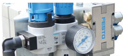
Пневмопривод фасонной гильотины
